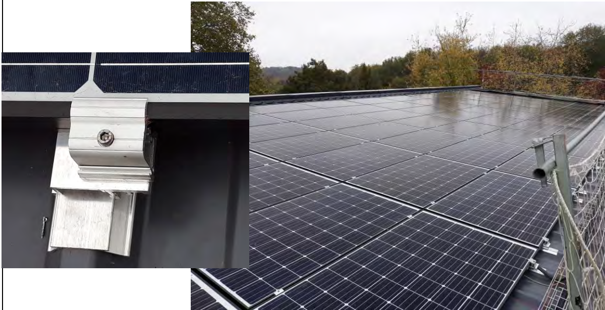
La centrale solaire en images
