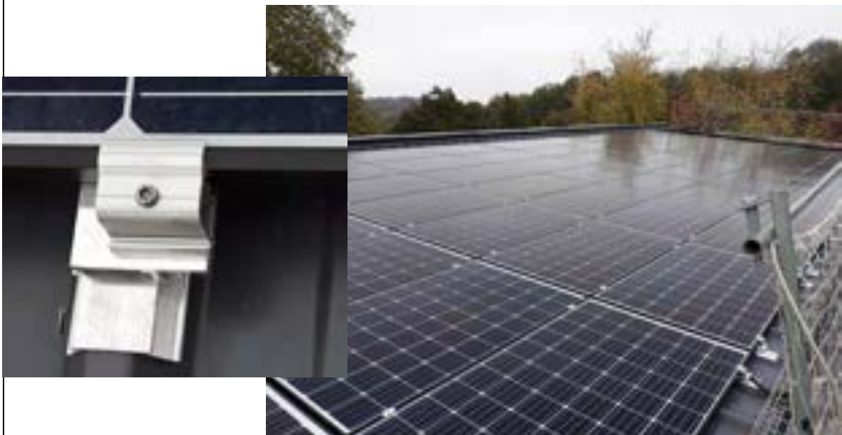
La centrale solaire en images
