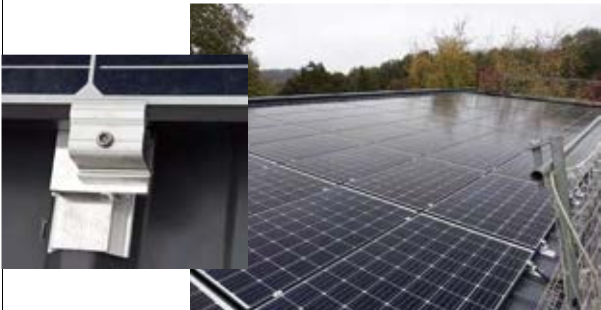
La centrale solaire en images
