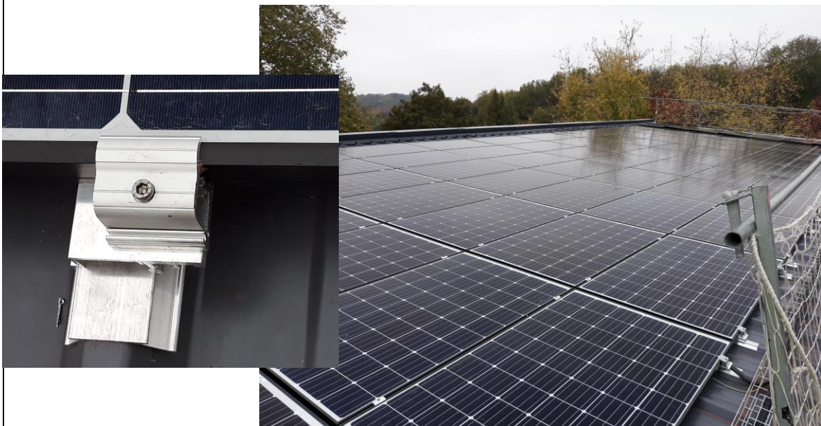
La centrale solaire en images
