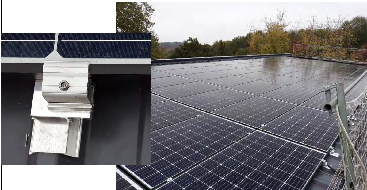
La centrale solaire en images
